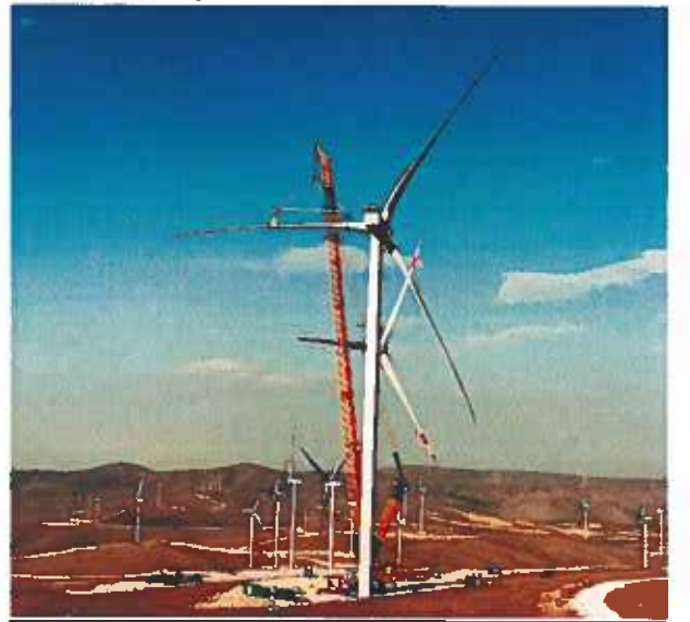
BAĞLAR RÜZGAR ENERJİ SANTRALİ PROJESİ
