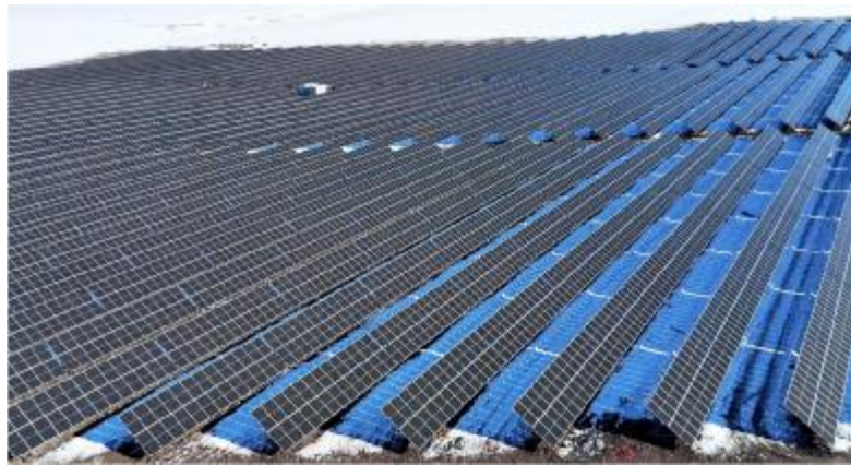
Kars Arazi Güneş Enerjisi Santrali
