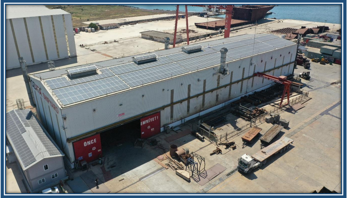
Şekil 7. Bina Üstündeki Güneş Panellerinin Görünümü
