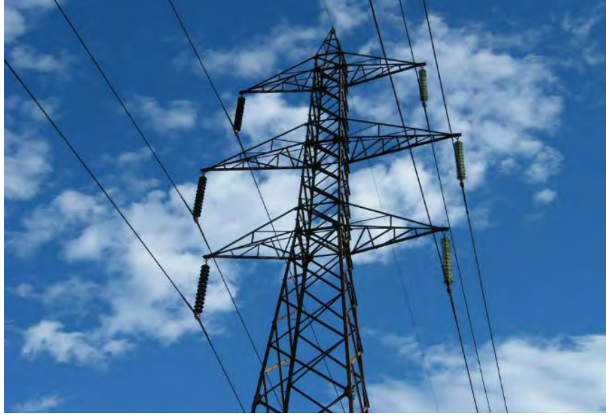
154 kV Taşıyıcı Direk
