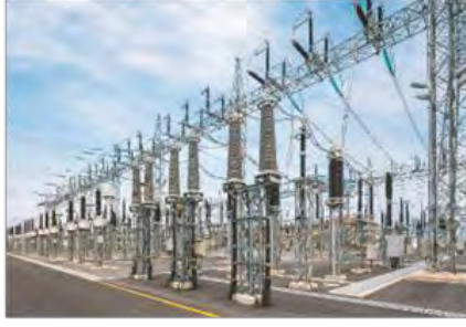
Trafo Merkezi Çelikleri
