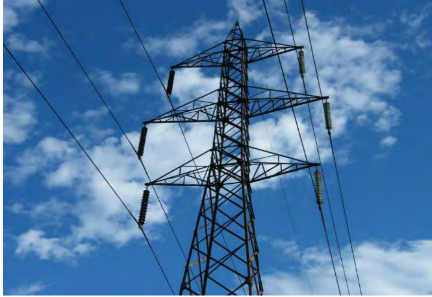
154 kV Taşıyıcı Direk
