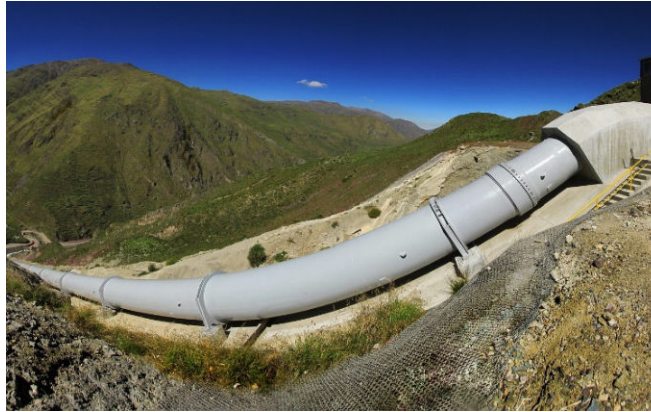
Çukurçay HES Cebri Boru Hattı
