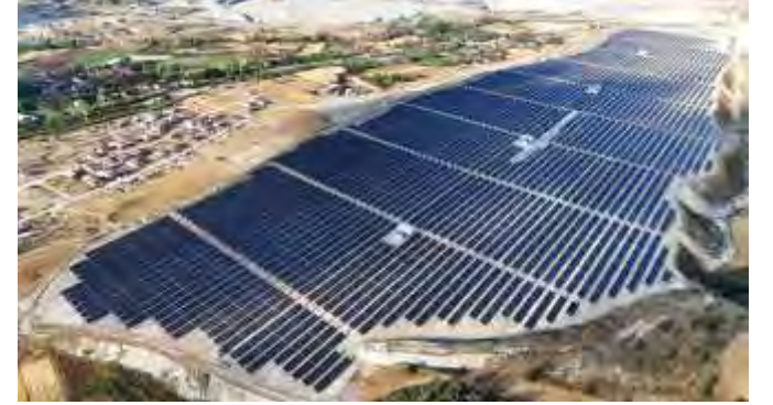
Aksa GES, Gönük
